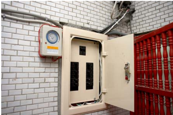
電源專線並沒有經過該樓層的電箱
