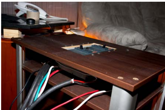
斷路器(breaker)的控制就安裝在桌子
